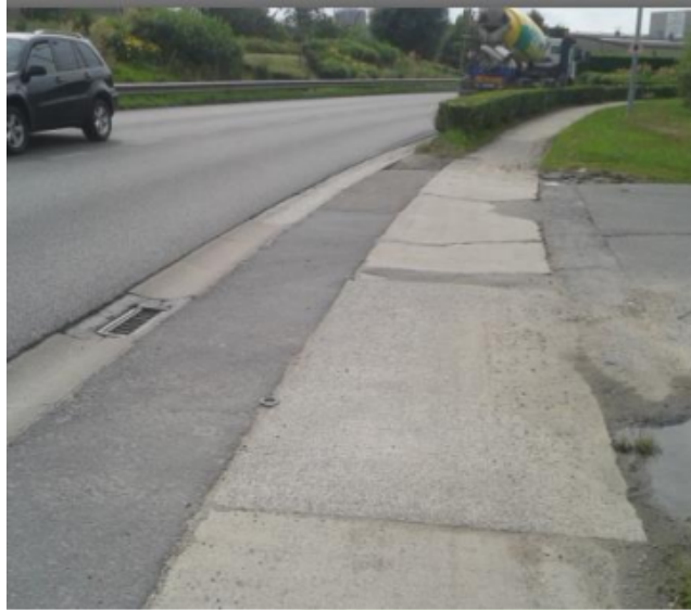
Fig. 87: Breed afgescheiden fietspad, in slechte staat, dat niet meer in aanmerking komt voor renovatiesubsidie
